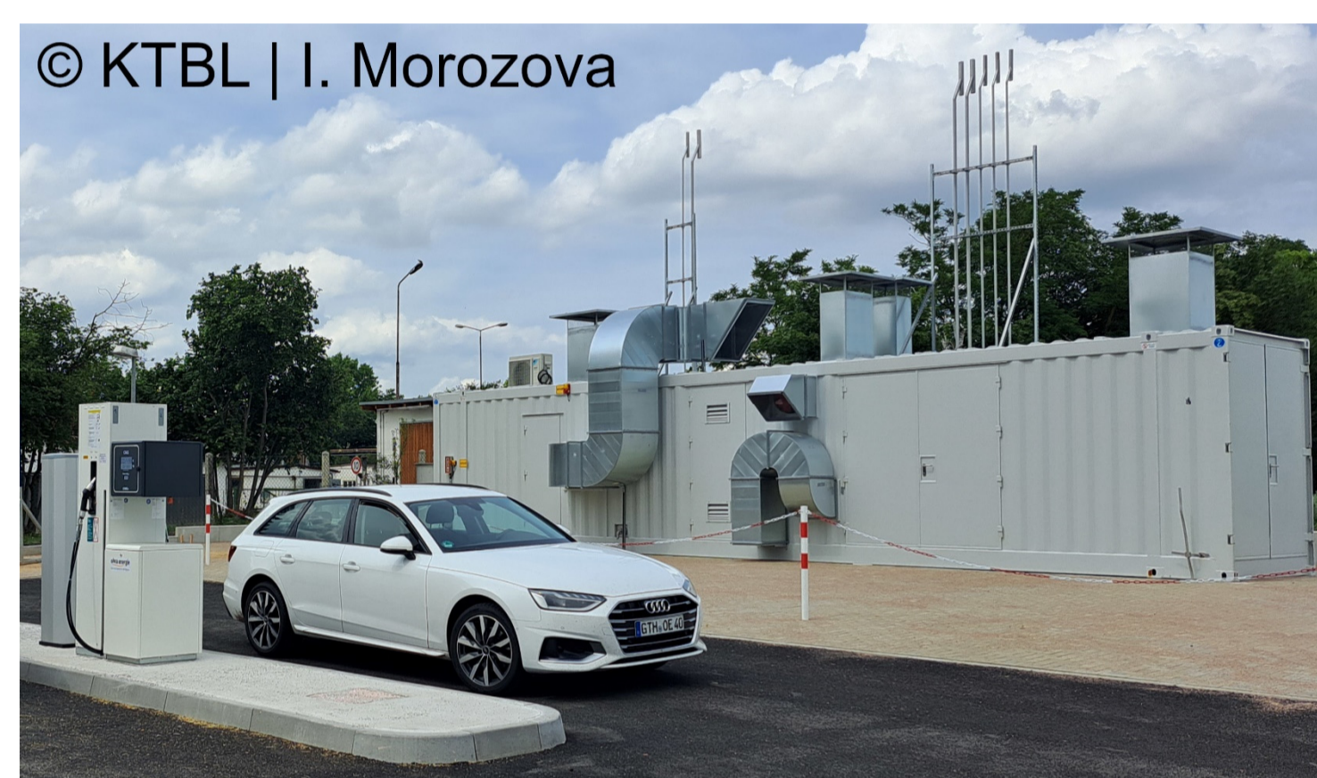
© KTBL | I. Morozova Produktionsanlage für Bio-CNG mit Tankstelle
